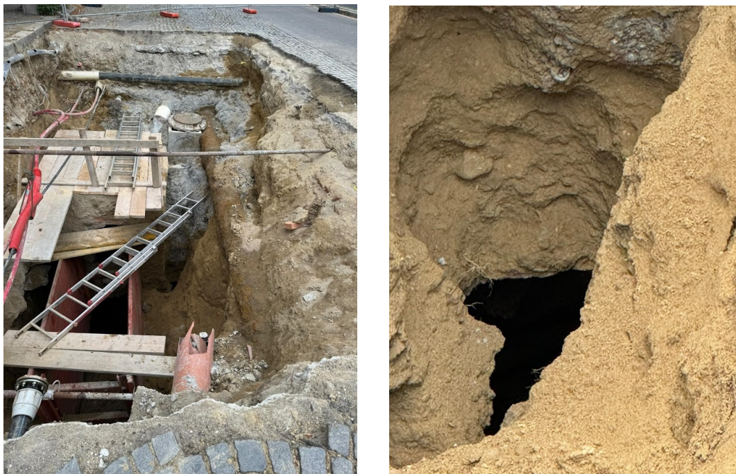
Foto 3 e 4 – terzo dissesto individuato (parete pozzetto lato carreggiata interna di Corso Torino)
